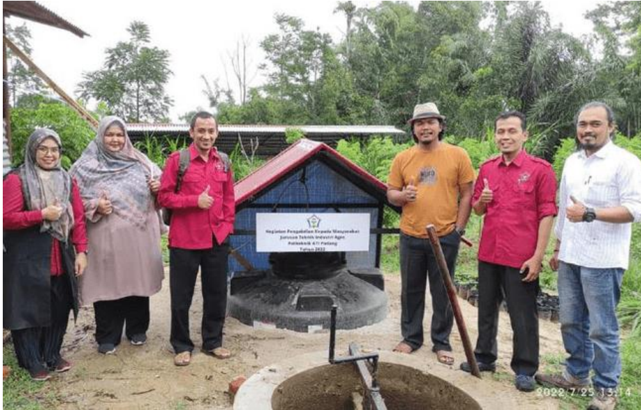
Gambar 2. Instalasi digester biogas pada kegiatan PKM tahun 2022
