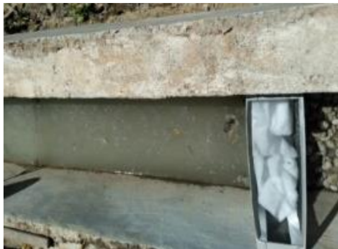
Gambar 4. Penyumbatan akibat filtrasi
