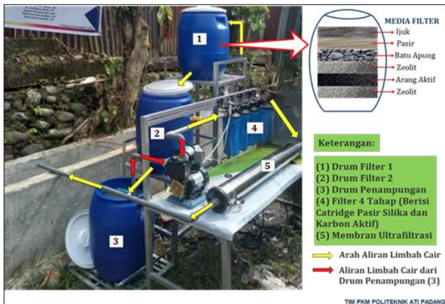
Gambar 6. Instalasi alat pengolahan limbah cair tahu dengan teknologi ultrafiltrasi
